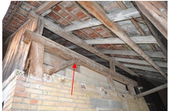
Abb. 24: Östlicher Anbau, Blick an die Ostfassade mit stark vorkragendem Pultdach. Zweitverwendete Hölzer mit überblatteter Kopfstrebe (roter Pfeil).
